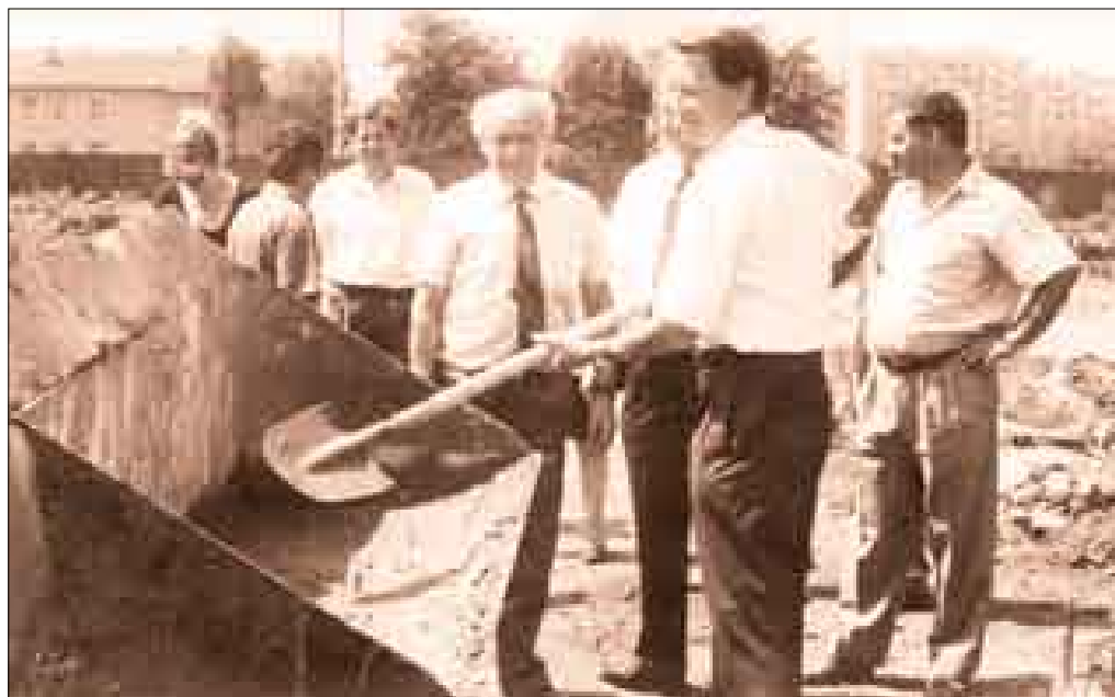
Август - Първа копка на търговско-сервизния комплекс в Люлин, София. Продажби, сервиз и резервни части ще бъдат под един покрив. И само на няколко десетки крачки от клиента.
